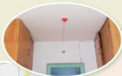
天花消防 警報器
